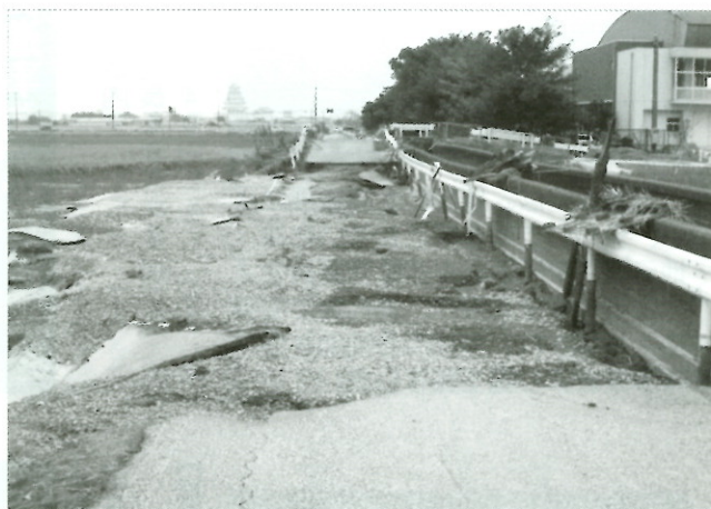
常総市 小保川支線用水路（管理道路崩壊土砂流入）
