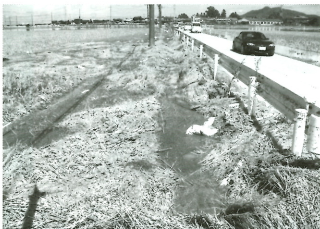
常総市 県営六軒支線用水路（切藁・ゴミ流入）
