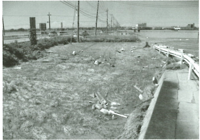
常総市 豊田地先八間堀 (切藁・ゴミ流入)
