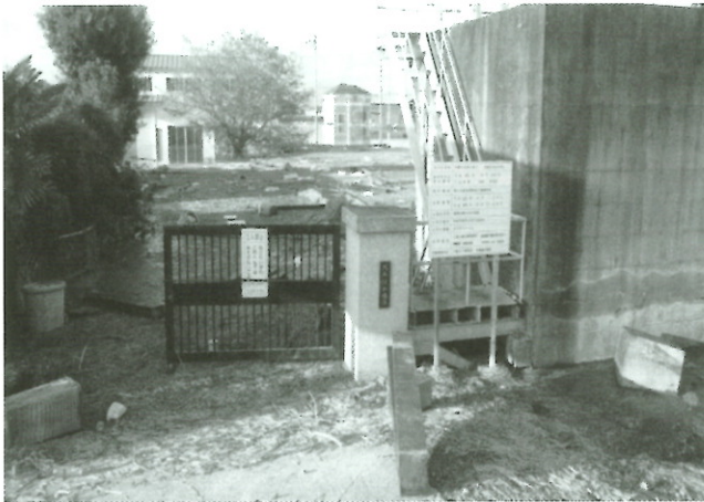
常総市 大生排水機場敷地 (切藁・ゴミ流入)
